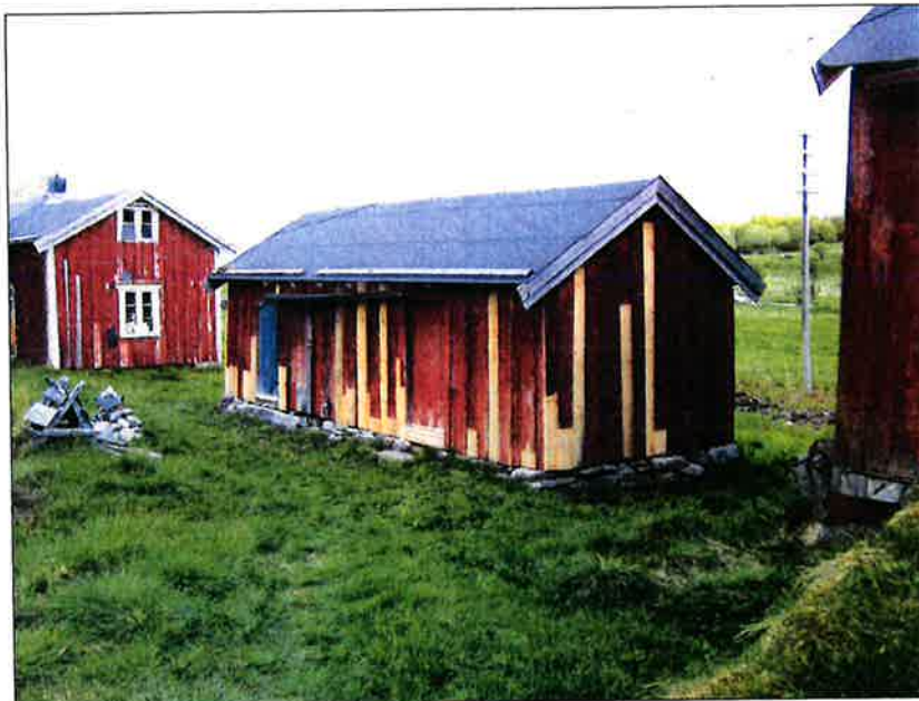
Vedskjul/stall. Utbedret. (Foto: Nordland fylkeskommune, 2005)
